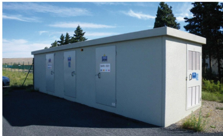
Figure 48 : Exemple de poste de livraison (Source : Photosol)
